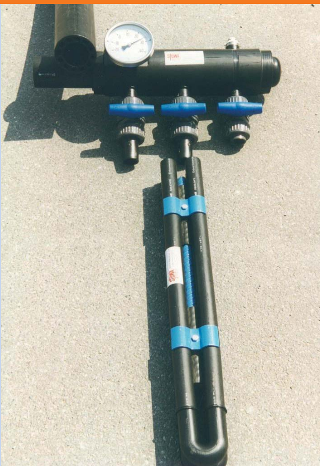
Doppel-U-Rohr-Erdsonde, Armaturen und Verteilungsleitung zur Wärmepumpe
