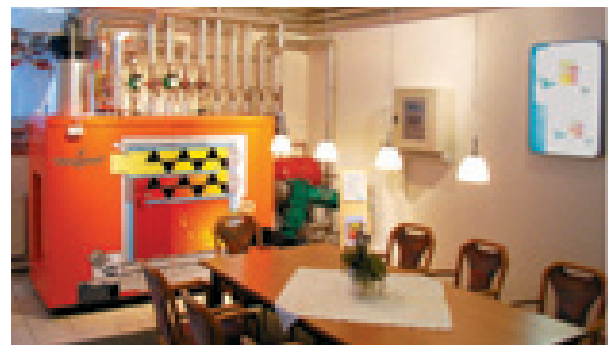
Heizomat Biomassekessel 60 kW (in Betrieb)
